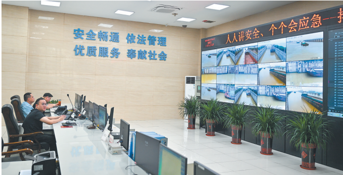
船闸智能化调度将船舶平均待闸时间缩短2至3小时，大幅提升船舶通行效率，缓解通航压力。
