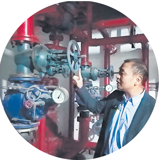
天心丽城小区消防系统焕然一新。
