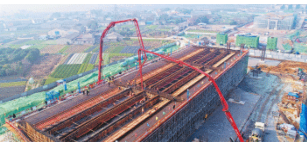
顺接湘府东路跨浏阳河大桥，全长4.8公里的湘府东路(浏阳河—黄兴大道)已动工，正在进行沿线桩基和下部结构施工，首根箱梁已顺利完成浇筑。长沙晚报全媒体记者 王志伟 摄
